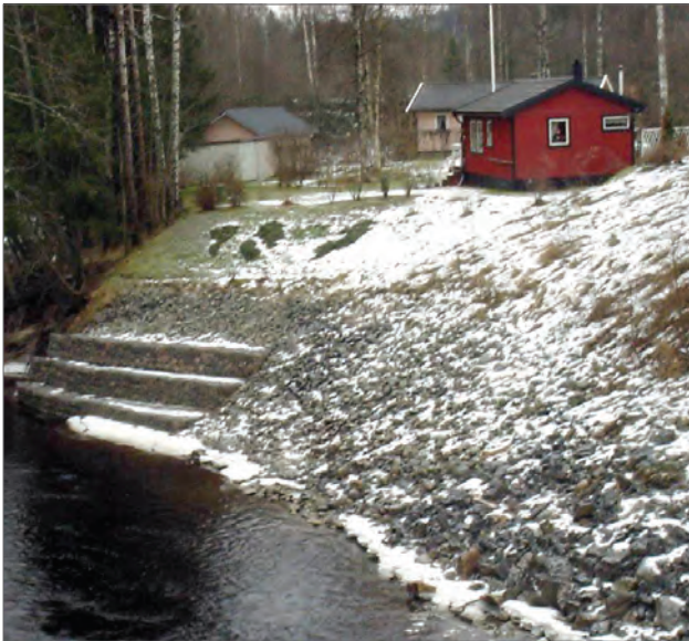
Erosionsskydd Kvarsätt. Foto: Hans Lyman, miljökontoret.
